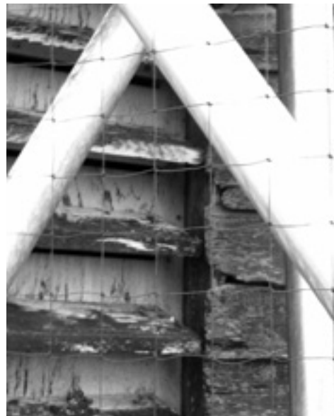
Von Weitem sieht man nichts, umso dramatischer sind die Schäden aus der Nähe.
